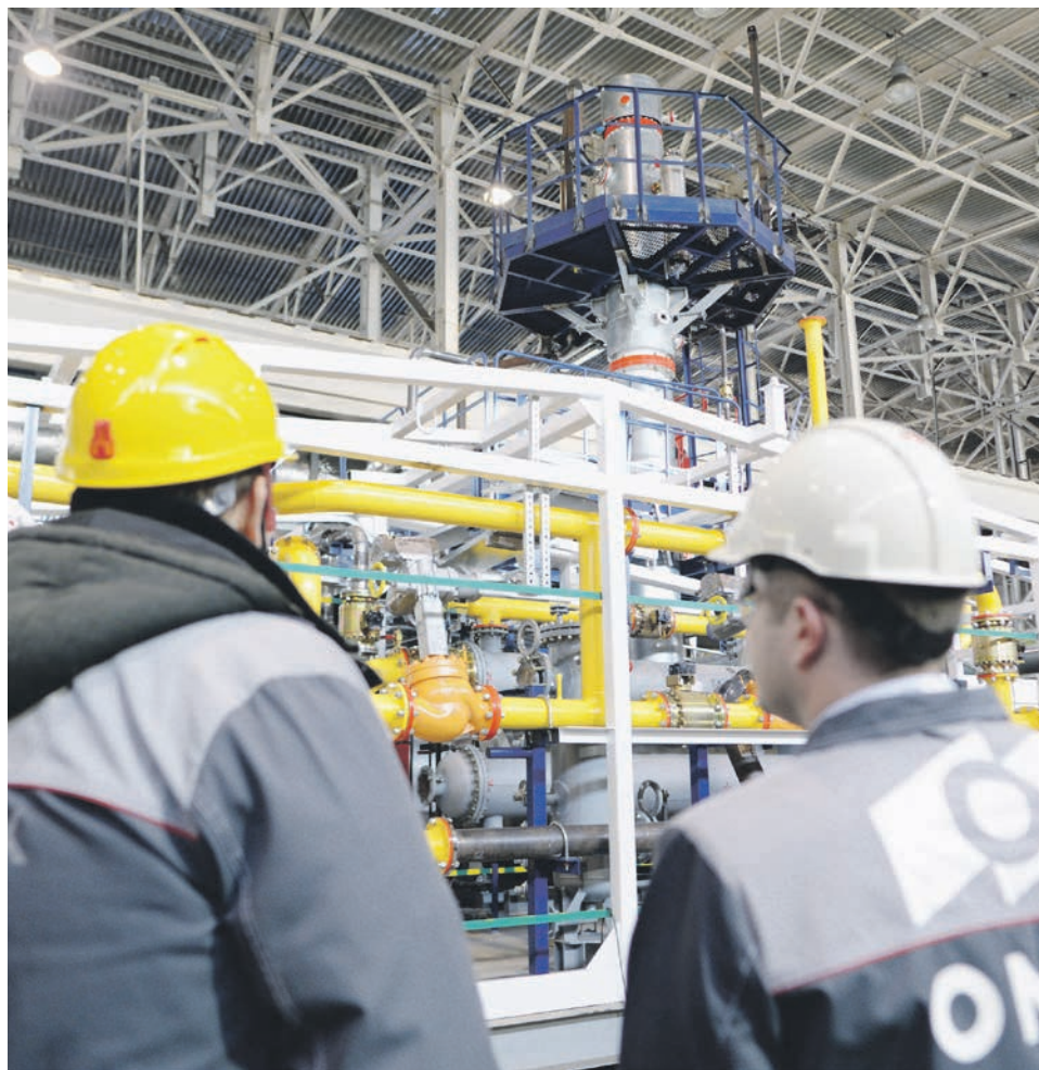
△ Блок отбензинивания газа производства «Трубодетали» впечатляет © НИКИТА ИСАКОВ
